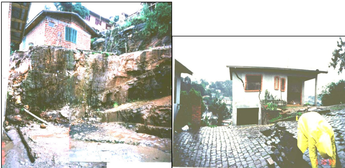
Figura 30. Deslizamento misto, em rocha descontínua, no bairro Kaiser. Extraído de Bressani (2013).
