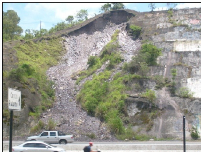
Figura 06 - Deslizamento da inclinação da BR-040 Road, Estado de Minas Gerais. Extraído de Parizzi (2014).
